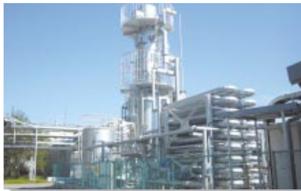
排水処理設備（敦賀事業所）
