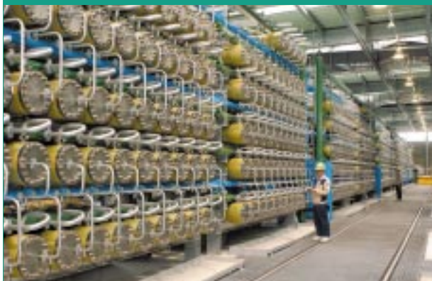
海水淡水化プラント内に設置された「ホロセップ ® 」逆浸透膜モジュール群
